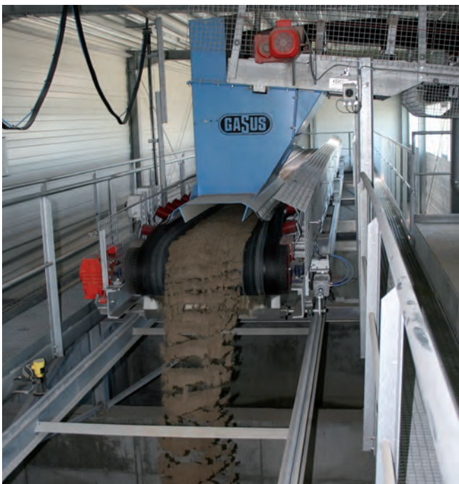
Из скипового подъемника заполнители попадают через распределительный транспортер в один из 8 бункеров
