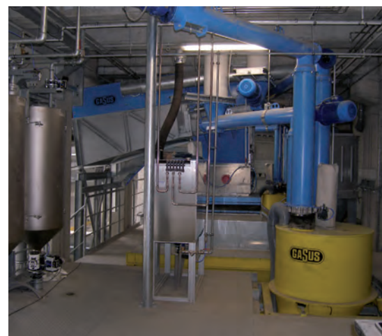
Герметичная транспортировка заполнителей, веса для воды, шлама и цемента
