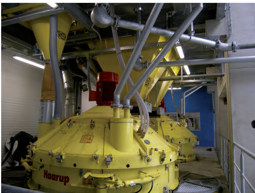
Планетарные смесители Haugrup 3000, бункера для хранения заполнителей и весовая цемента
