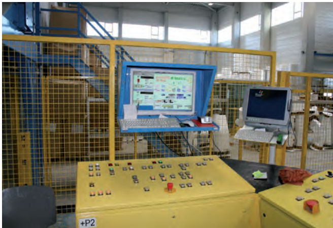
Операционный пульт станции бетонирования позволяет наблюдать за всеми производственными процессами
